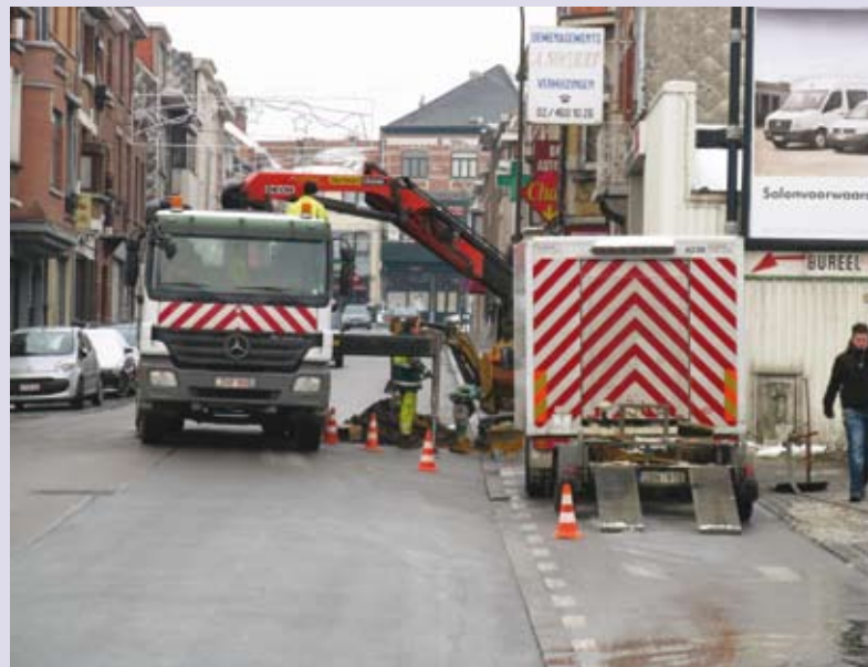
Door de vrieskou sprong begin januari de hoofdwaterleiding aan de Steenweg op Merchtem.
